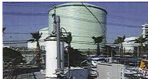
〈火力発電所〉(食品工場)硫化水素除去
