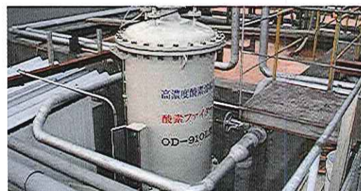
〈廃水処理〉悪臭・騒音・脱水汚泥の低減
