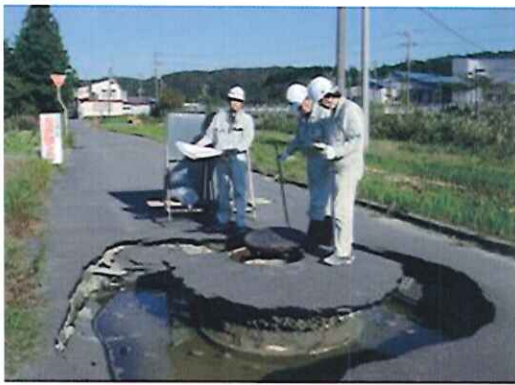
下水道管の破損
